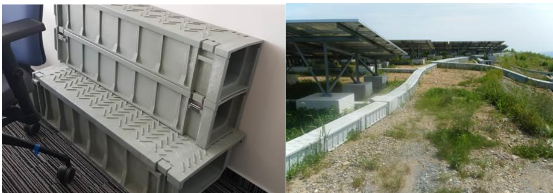
Εικόνα 13: Επιφανειακοί αγωγοί τοποθέτησης καλωδίων
